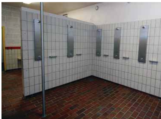
Dusjanlegget i Tastahallen, hvor en eldre mann ble smittet av legionella i 2007. FOTO: THOMAS FOSSE
